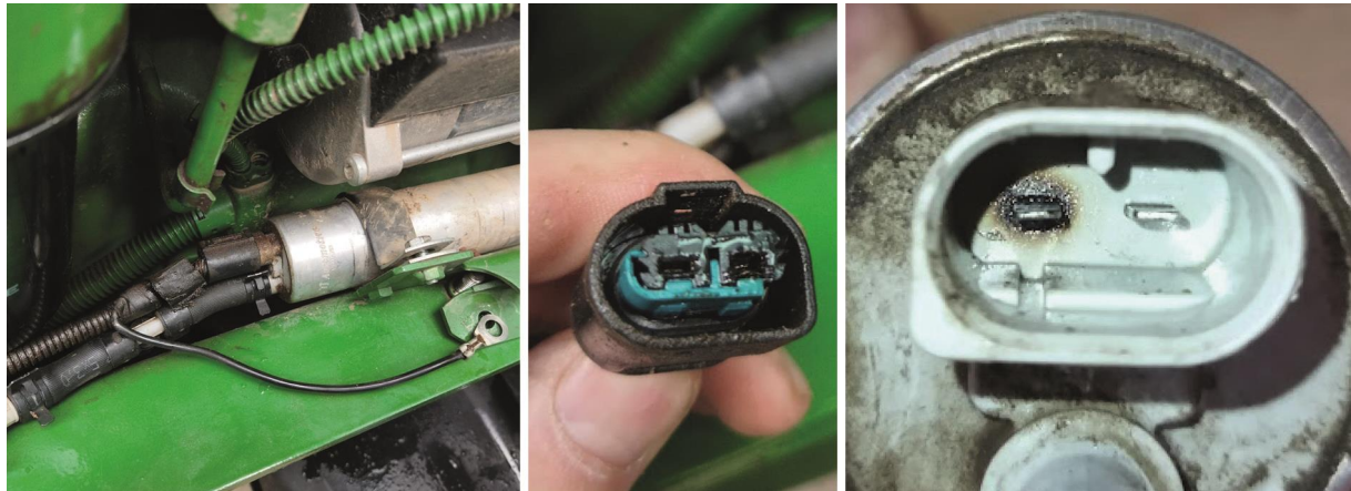
Abbildung 18: Fehlerhafte Steckverbindung für die Stromversorgung der Kraftstoffpumpe
